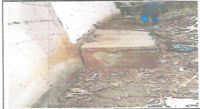
Foto 2: Banqueta del lado de atrás de la parte alta de la escuela destruida
