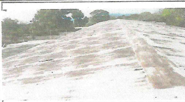
Foto 1: Lamina dañada de la parte baja izquierda de la escuela
