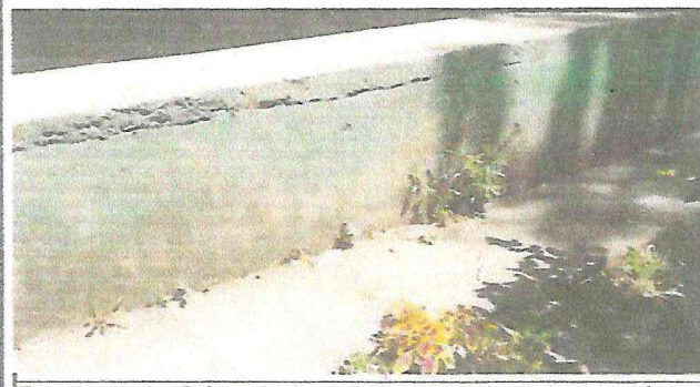
Foto 5: corredor de la parte alta de la escuela esta gretado y muy alto.
