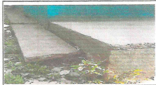
Foto 4: Banqueta del lado alto de la escuela destruida
