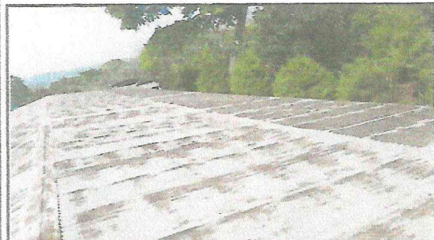
Foto 3: Lamina de la parte baja lado derecho en mal estado
